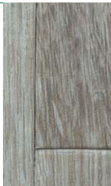
● Spáry na vinylové podlaze po 1 roce - přípustný rozměr
